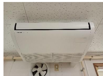
課外活動共用施設の空調設備
