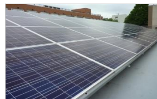
太陽光発電設備
