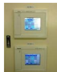
空調機 集中コントローラー
