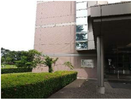
① 10号館玄関脇のモミ：樹木の先端部から徐々に立枯れしている。
