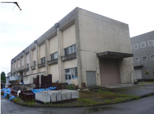
建設実験棟 (建物の老朽化が著しい)
