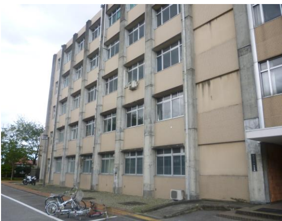
峰町6号館 (建物の老朽化が著しい)
