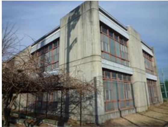
武道場 (建物の老朽化が著しい)
