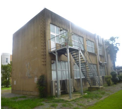
峰町2号館D棟 (建物の老朽化が著しい)
