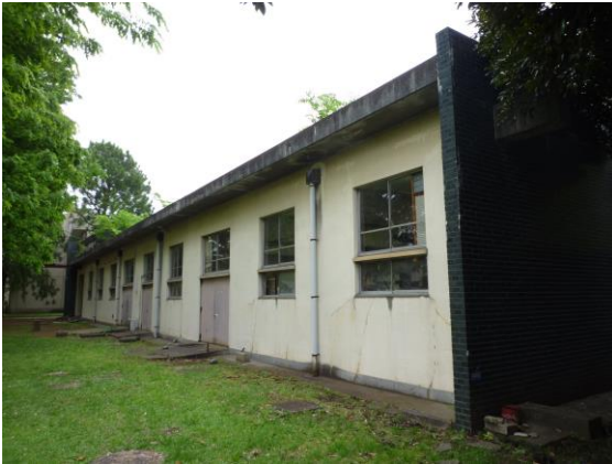
工学部 6 号館 (機械・電気実験室) (建物の老朽化が著しい)
