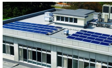
太陽光発電設備
