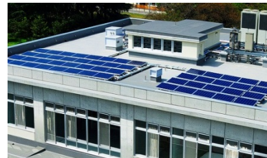
太陽光発電設備
