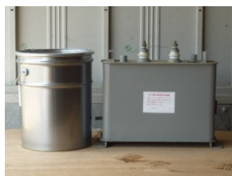
高濃度PCB廃棄物の保管の様子
